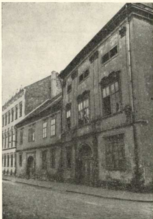
1. A Fegyvertár utca 3. sz. épület deformált homlokzati fala
