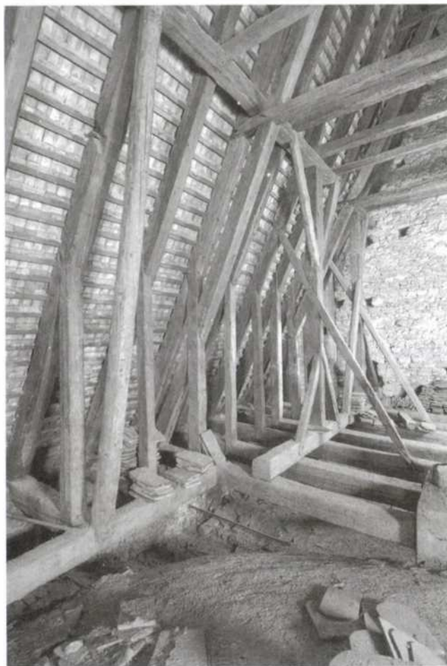
7. ábra A Szentlélek-templom tetőszerkezetének középső, 18. században átalakított része. Az eredeti székoszlop helyére ferde oszlop került, a hajdani dúcok és könyökfák fészke jól látszik. Ezen a szakaszon eltávolították a székállás talpgerendáját is, és fiókgerendás-fiókváltós rendszert alakítottak ki (fotó: Ágh András, 2005.).
